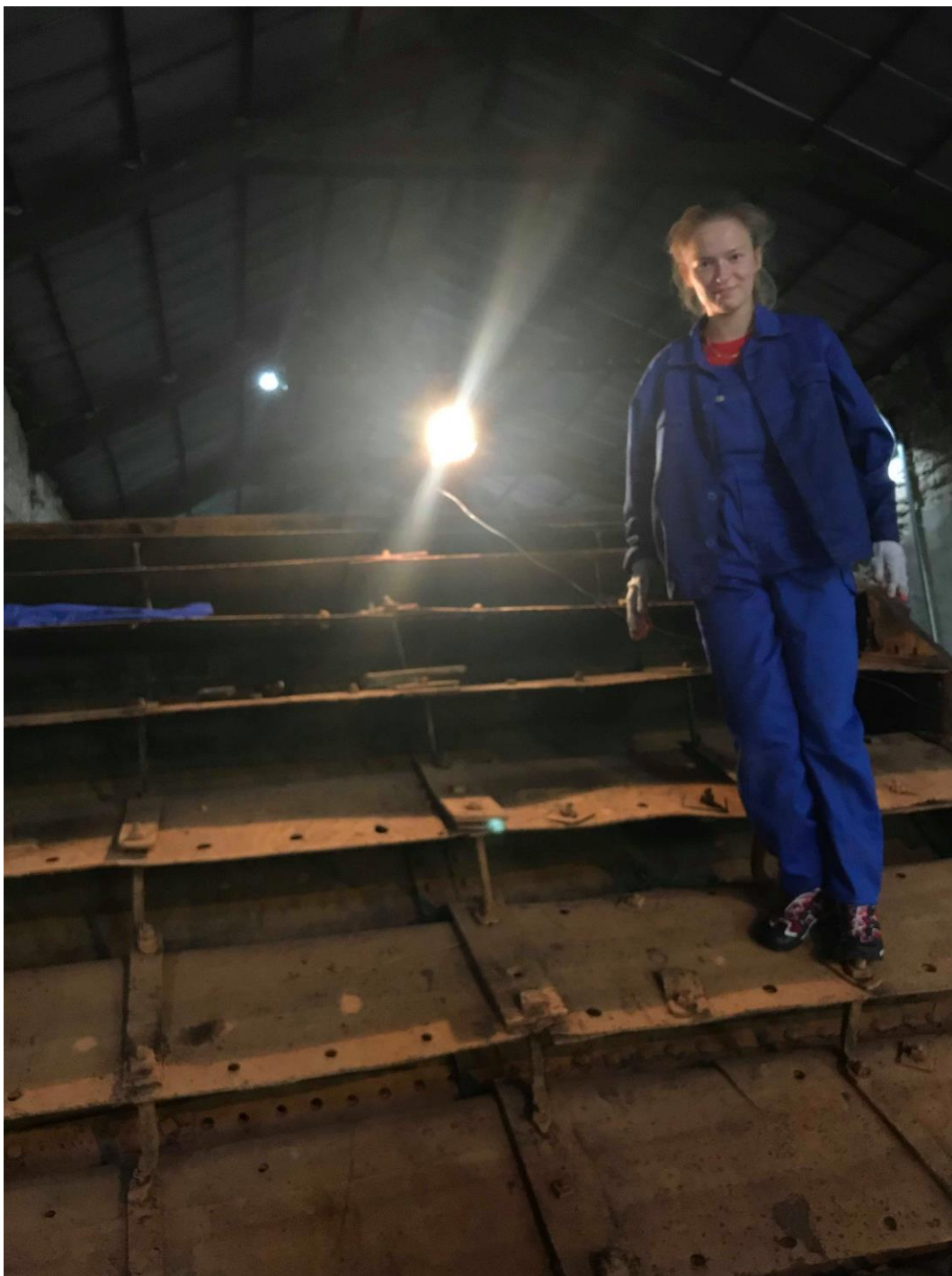
Rys. 1. Wygląd fragmentu koła wodnego od strony karczówek przed przystąpieniem do prac remontowych
