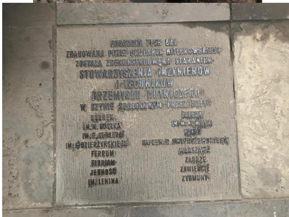
Rys. 20. Wyczyszczona i zakonserwowana jedna z tablic pamiątkowych oraz jedna z pamiątkowych płyt podłogowych
