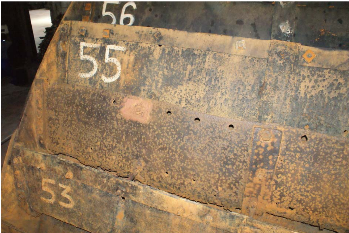
Rys. 1. Widok karczówek nr 53, 54 i 55 przed remontem i konserwacją
