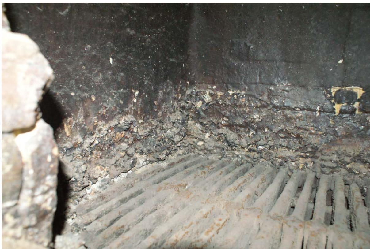
Rys. 5. Widok stanu komory paleniskowej i rusztu przed remontem
