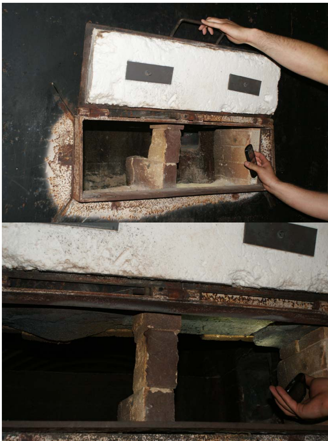
Rys. 14. Stan wymurówki czoła pieca ponad listwą żeliwną rusztu oraz okna rusztu
