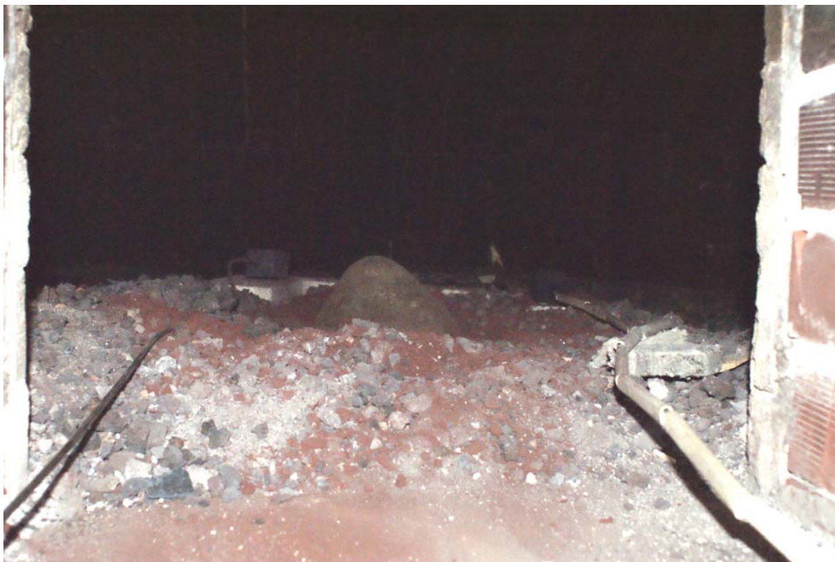
Widok nowego wyłożenia pod gąskę surówki w komorze wyrobowej pieca wraz z zainstalowanymi termoelementami
